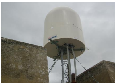
Fig. 1 Sistema radar WR10X installato presso Castel Sant'Elmo (NA).
