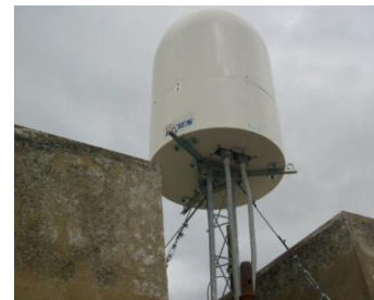
Fig. 2 Il radar meteorologico WR-10X installato nella città di Napoli presso il sito di Castel Sant'Elmo.
