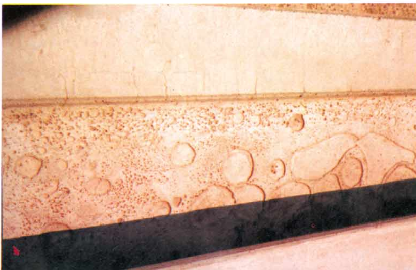
Foto 10 - Lo spessore di lattime accumulato (qui fino a 2 cm!) non è sicuramente copriferro adeguato né agli effetti statici né della durabilità
