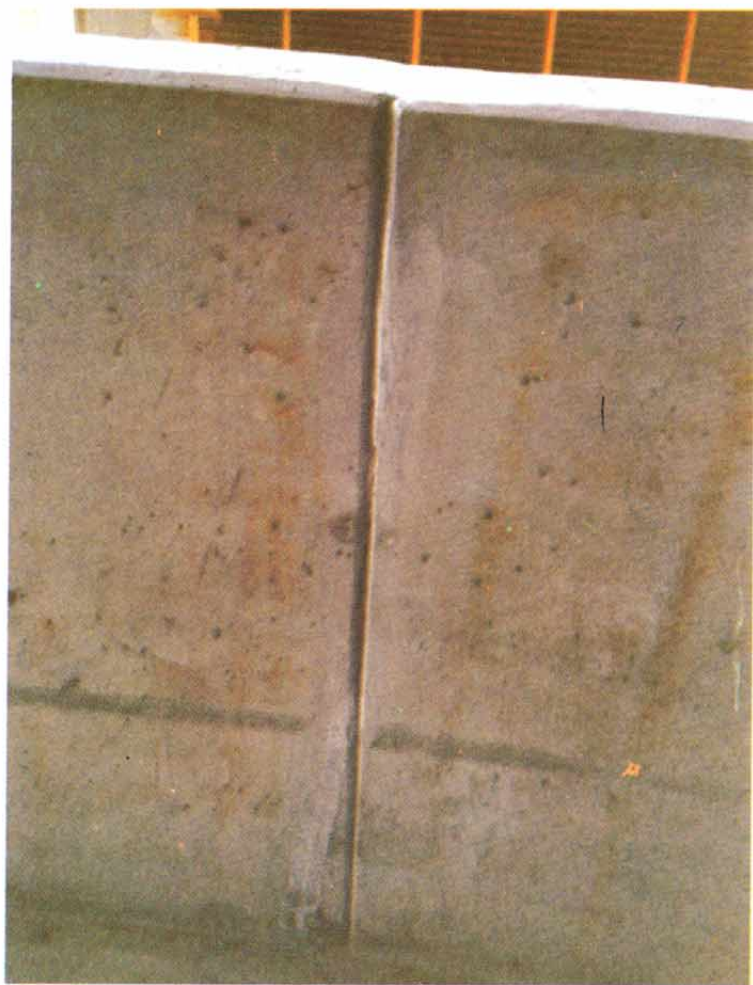
Foto 8 - Affioramento di ruggine non significativi
