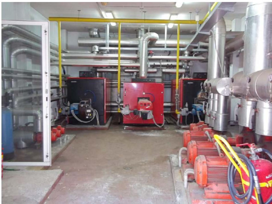
IMMAGINE DELL' INTERNO DELLA CENTRALE TERMICA
