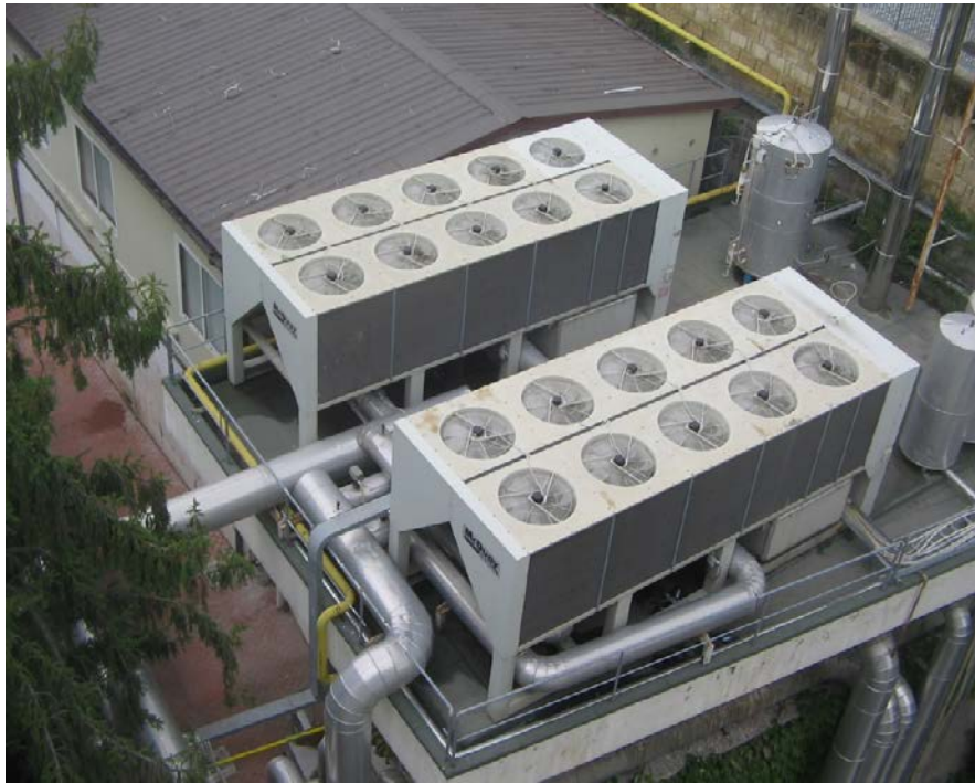
IMMAGINE DEI 2 GRUPPI FRIGO ARIA/ACQUA TIPO EHP DA 630 KWf
