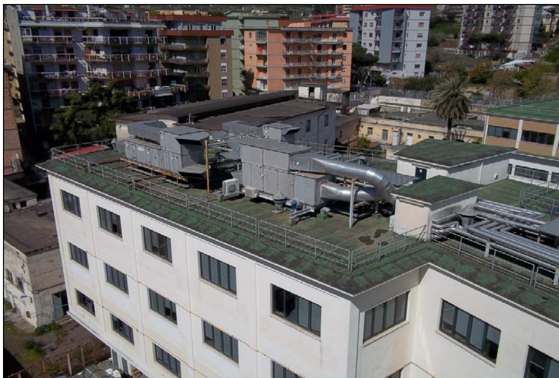
IMMAGINE DI 2 UNITA' DI TRATTAMENTO ARIA ESTERNA SULLA COPERTURA DEL COMPLESSO
