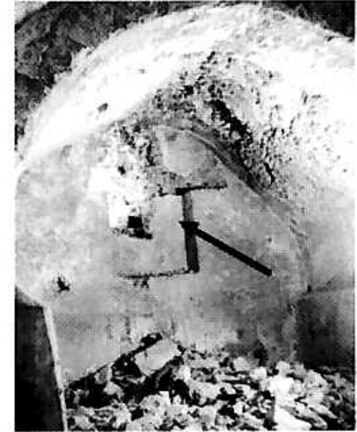
78. Mercato S. Severino. Interno del Cisternone. La freccia indica un'apertura che doveva consentire il prelievo dell'acqua direttamente dal loggiato antistante l'invaso, lungo la parete W.
