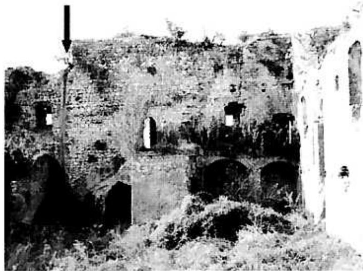
54. San Felice a Cancelli. Castello di Matinale, corte interna. La freccia indica l'alloggiamento del pluviale.
