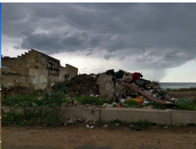
Fig.8: accumulo di rifiuti raccolti dalla pala
