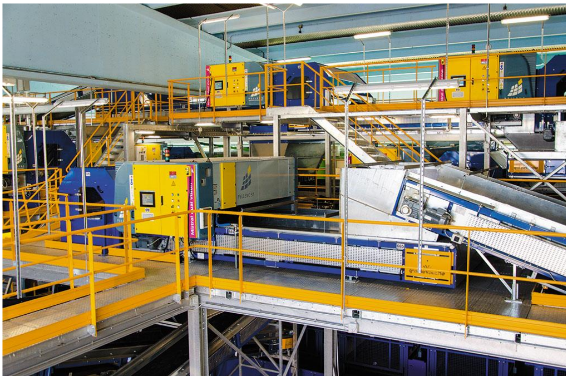
Figura 11. Particolare degli impianti di selezione di Ambiente SpA
