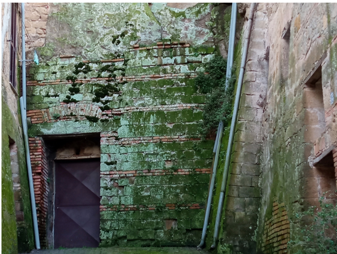
Fig. 16: Crescita di patine biologiche in un muro della parte del borgo esposta a nord.
