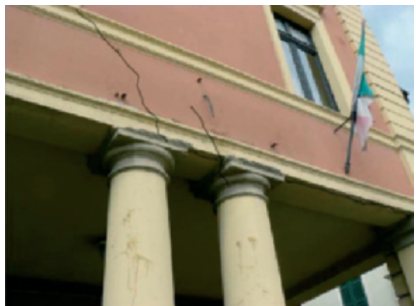
Fig. 4b - Lesioni all'intradosso del portico.
