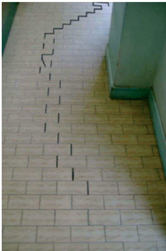
Fig. 4d - Lesioni sul piano di calpestio.
