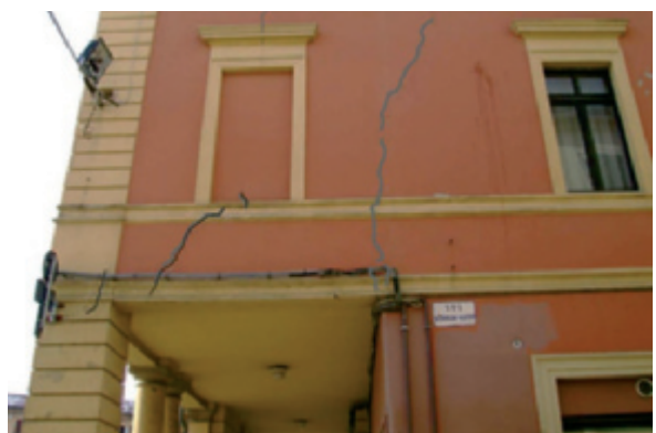
Fig. 4c - Lesioni sul prospetto laterale.
