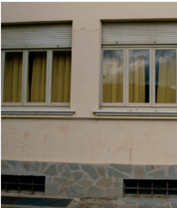
Fig 5/b - Particolare della lesione su uno dei «pilastri» del refettorio.
