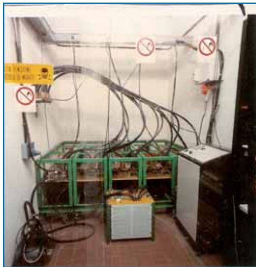
Fig. 7: Banco di condensatori del primo apparato di campi magnetici pulsati utilizzato presso l'Istituto MASPEC
