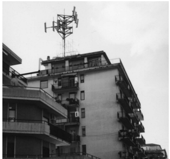
Fig. 4) - Antenna per la telefonia mobile, Catania.
