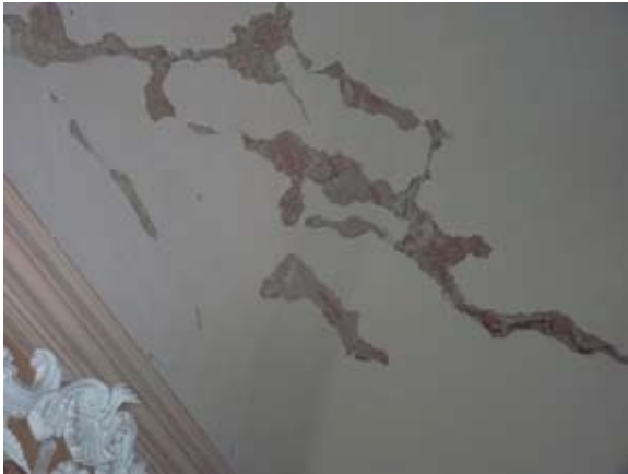
Fig. 13 Casi studio: B - Imola: le gravi lesioni sulla volta realizzata con mattoni disposti in foglio
