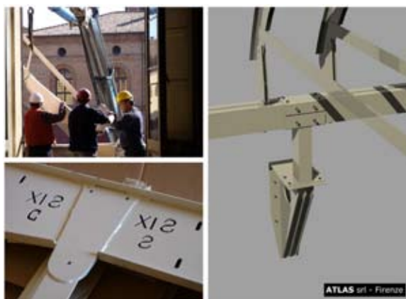
Fig. 15 Casi studio: B - Imola: fasi di trasporto delle cinte e 3d di progetto
