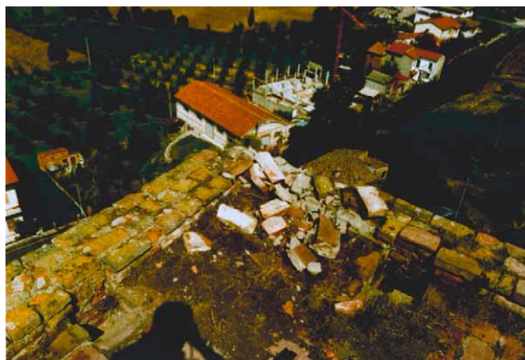
Figura 6: stato di degrado a seguito dello smontaggio del parapetto (anni '30-'40).
