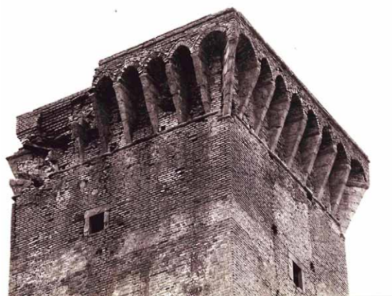
Figura 7: stato di degrado dei beccatelli della Torre.
