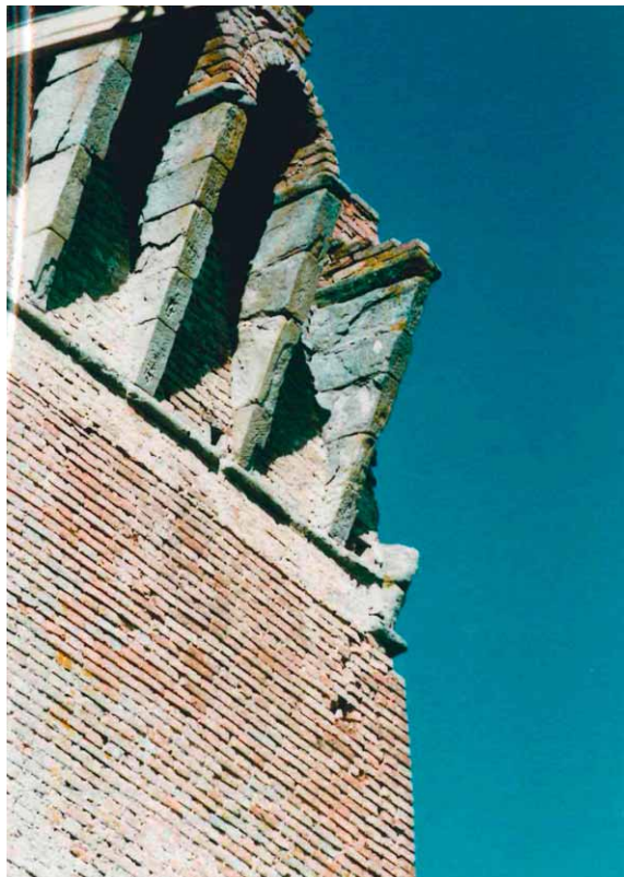
Figura 4: stato di conservazione dei beccatelli della Torre, prima degli interventi di restauro.
