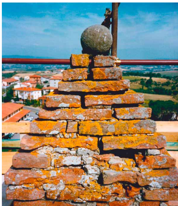
Figura 29: particolare dello stato di degrado del coronamento della Porta d'accesso.
