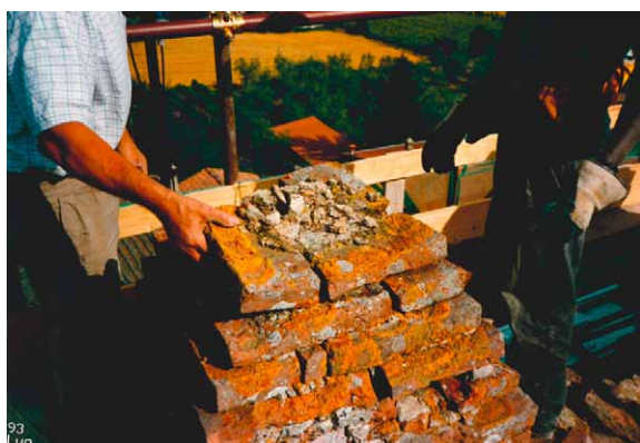
Figura 30: particolare dello stato di degrado del coronamento della Porta d'accesso.
