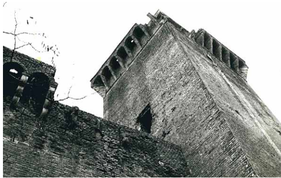
Figura 3: stato di conservazione dei beccatelli della Torre, prima degli interventi di restauro.
